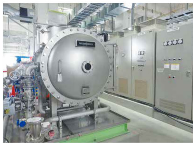
▲オゾンAOP施設。水質の改善が期待される
